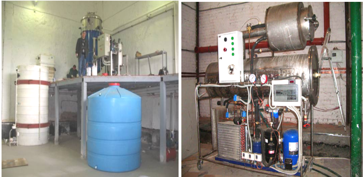
Рис. 2.8. Вакуумно-дистиляційна установка для обробки води
