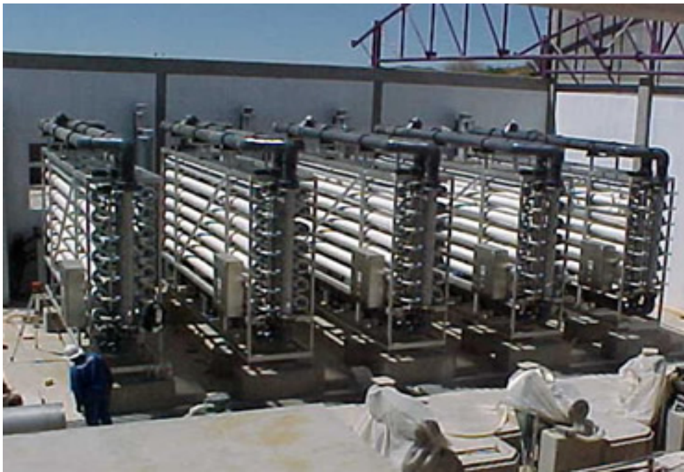
Рис. 4.7. Комплекс блоків ультрафільтрації на ВОС
